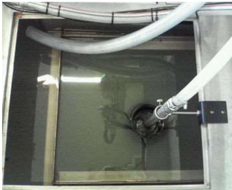
油水槽・固定式回収ノズル
